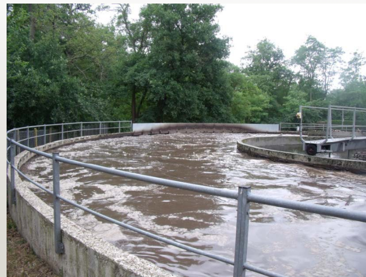
Bassin d'aération et clarificateur
